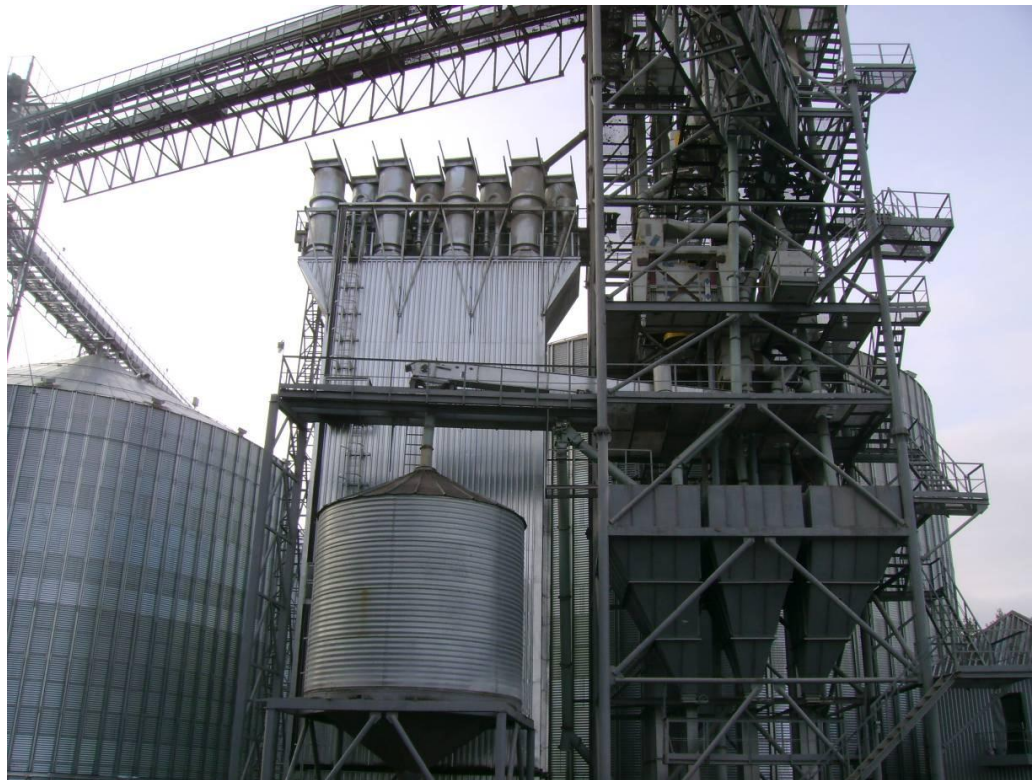
Рис. 1 – Загальний вигляд зерносушарки SCN-16/72 в складі зерносушарного комплексу
